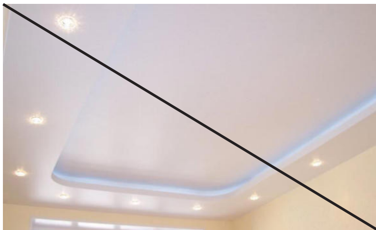
Плохо Многоуровневые гипсокартонные конструкции
